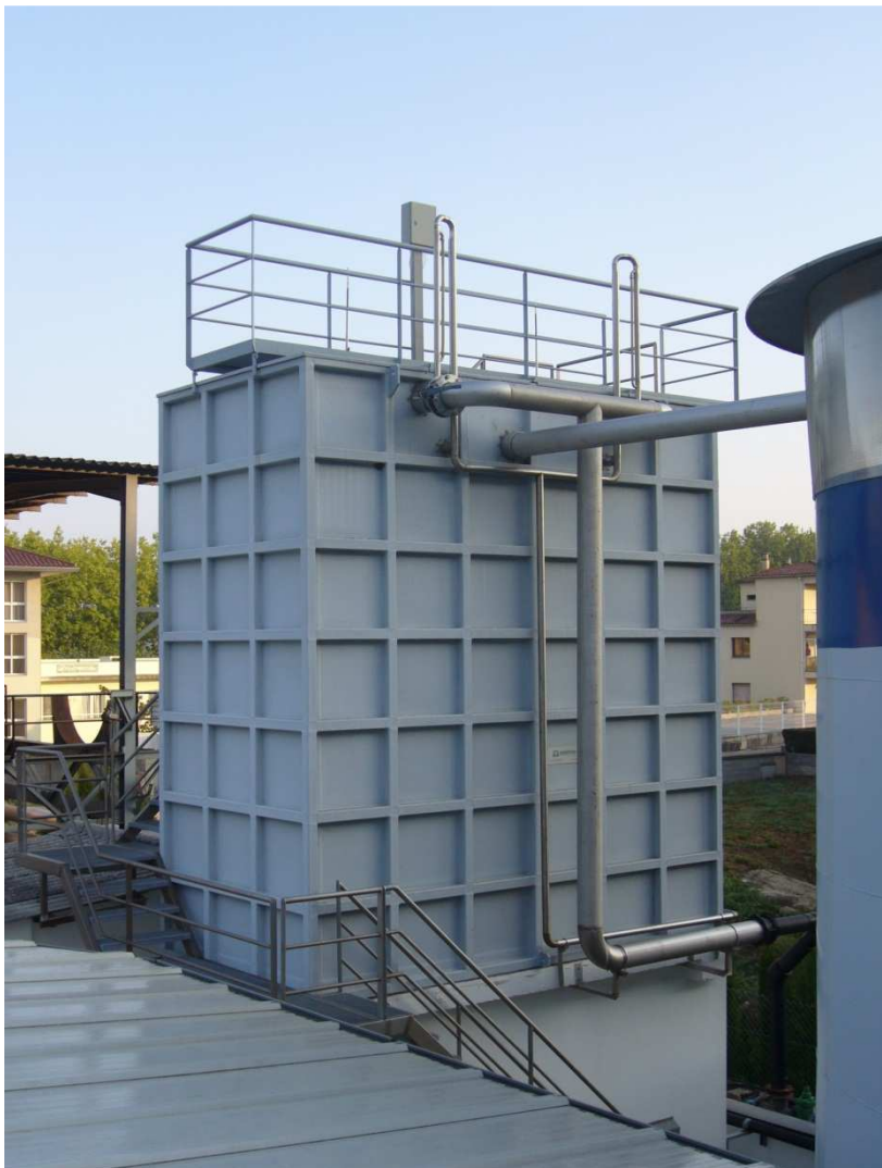
Fig.4. Filtres de sorra d'autorentat instal.lats en la planta potabilitzadora d'Aigües de Banyoles, SA:
